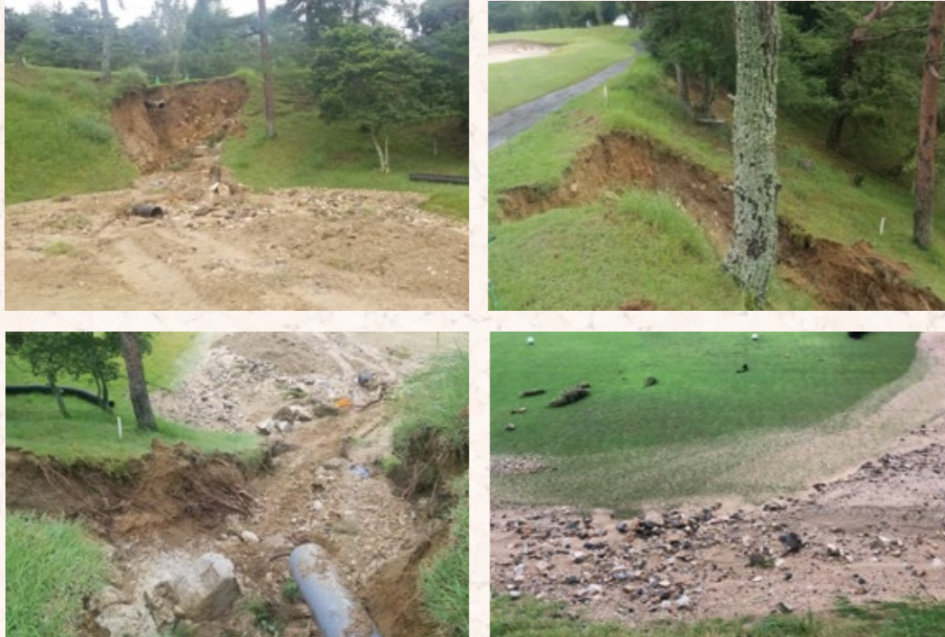
特に被害の大きかった1番ホールの様子です。
